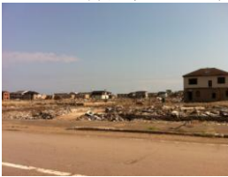
ほとんどの家が基礎以外全壊。残った家も住める状況にない
