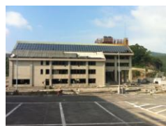
三階建ての屋根も津波の被害を受けている。
