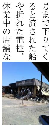
1階部分が完全にがれきりで埋まった店舗
